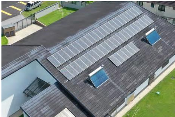
Kampung Baharu Nilai, Negeri Sembilan 30.26kWp
