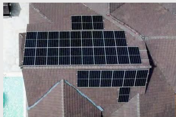
Kuala Terengganu 17.98 kWp
